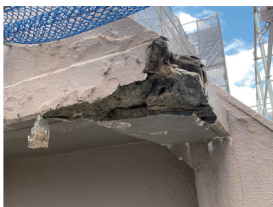
施工前 庇劣化状況
